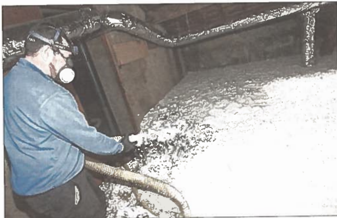
Pour que les aides à la rénovation énergétique soient activées, les particuliers doivent faire appel à des entreprises labellisées RGE (Reconnus garants de l'environnement). Mais le label ne met pas à l'abri des mauvaises surprises... Photo d'illustration Progrès/DR
